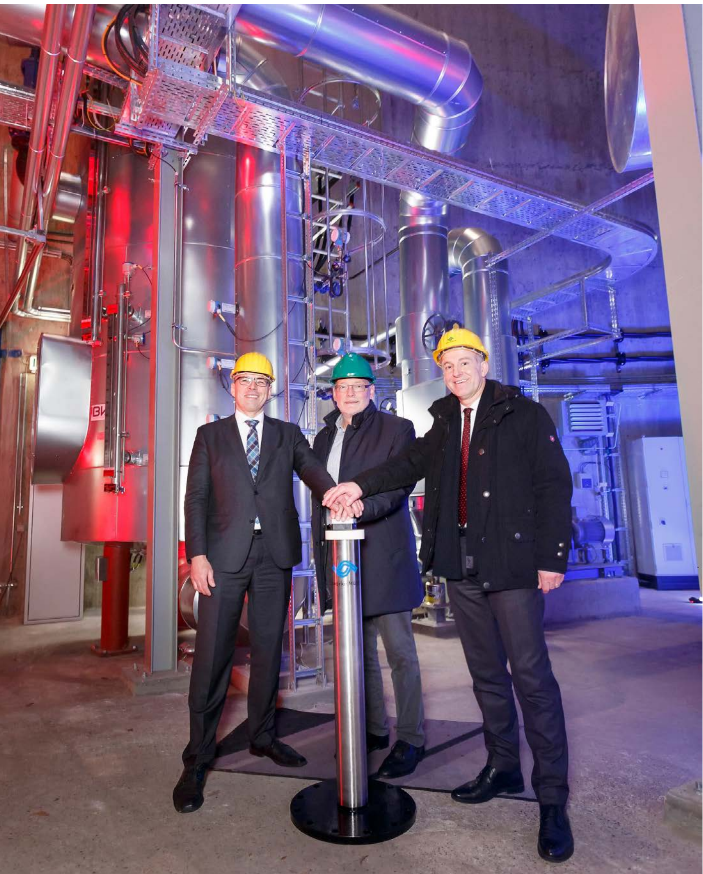
Inbetriebnahme des Elektrodenkessels der Stadtwerke Münster. Foto: MünsterView/Tronquet
