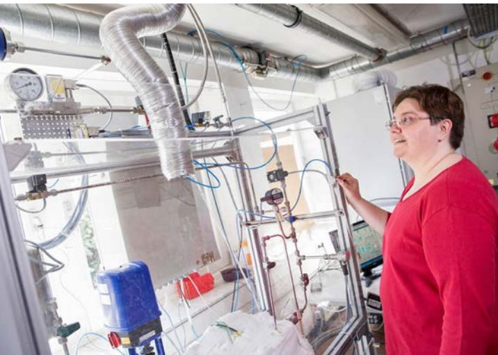
Power-to-Gas-Anlage mit Direktmethanisierung am HBFZ: Mit der Power-to-Gas-Technologie möchte das Fraunhofer IWES in Kassel die Langzeitspeicherung für die schwankende Erzeugung der Wind- und Solarenergie erreichen. Foto: think ING | Bokelmann
