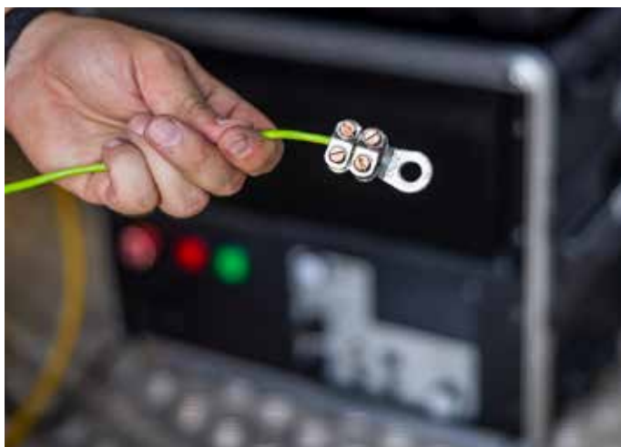
Für den unkomplizierten Einsatz im Windfeld. Hier: Ringadapter. © ENERTRAG / Silke Reents
