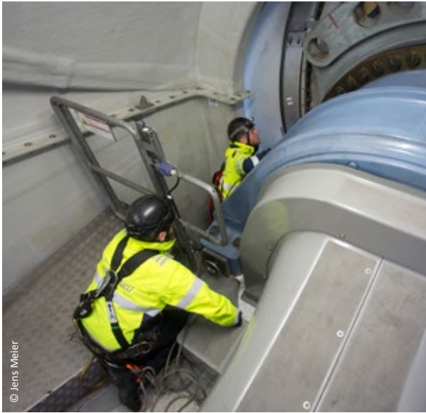
Technische Betriebsführung im Windpark Ammersche Länder
