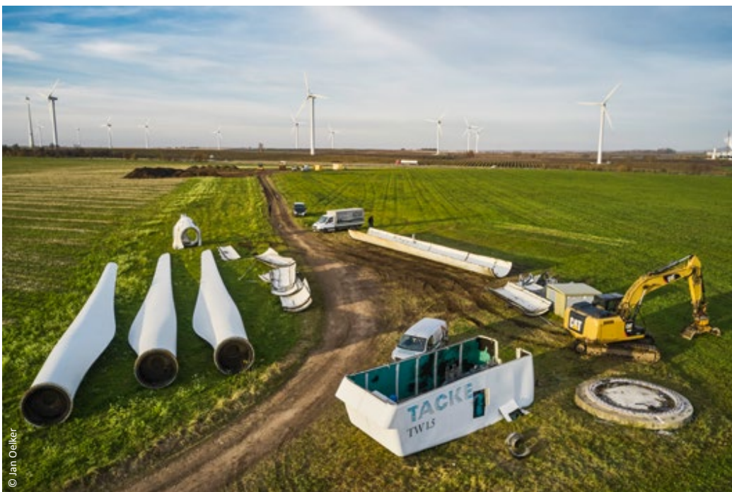
Beim Repowering im Windpark Sitten in Mittelsachsen wird eine Windkraftanlage Tacke TW 1.5s aus dem Jahr 1999 zurückgebaut und werden die Turmsegmente auf der Baustelle zur Verschrottung in Containergerechte Stücke zerteilt.
