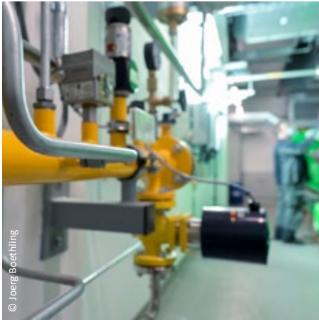
Hamburg, Hansewerk Natur, Blockheizkraftwerk der 1-MW-Klasse, das über Kraft-Wärme-Kopplung eine Siedlung mit Strom und Wärme versorgt.
